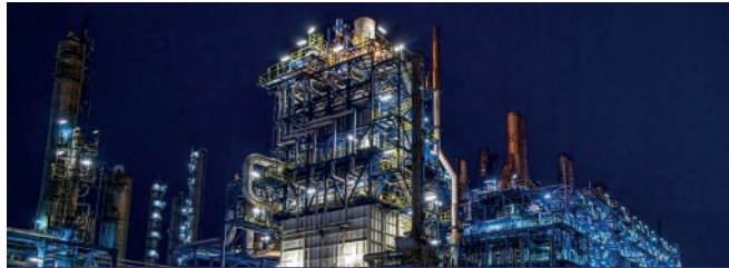
Enerji / Energy Türkiye / Turkey İzmir Aliağa Socar Üretim Tesisleri Izmir Aliaga Socar Manufacture Facilities Adet /Piece - Güç /Power : 1 x 415kVA
